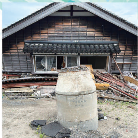
地震によって飛び出たマンホール
